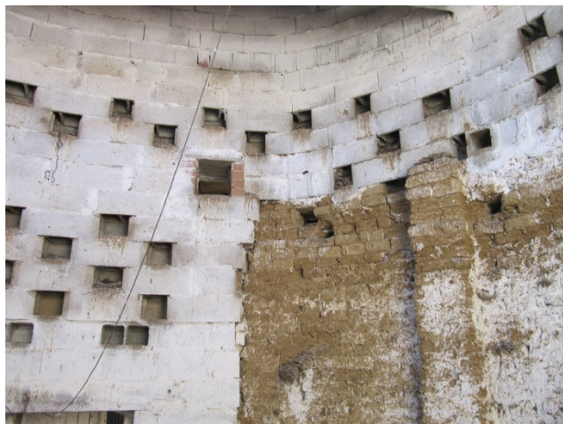
Figura 10. Detalle del encuentro de las fábricas de adobe y bloque. Julio de 2016 [©Javier Pérez Gil]
