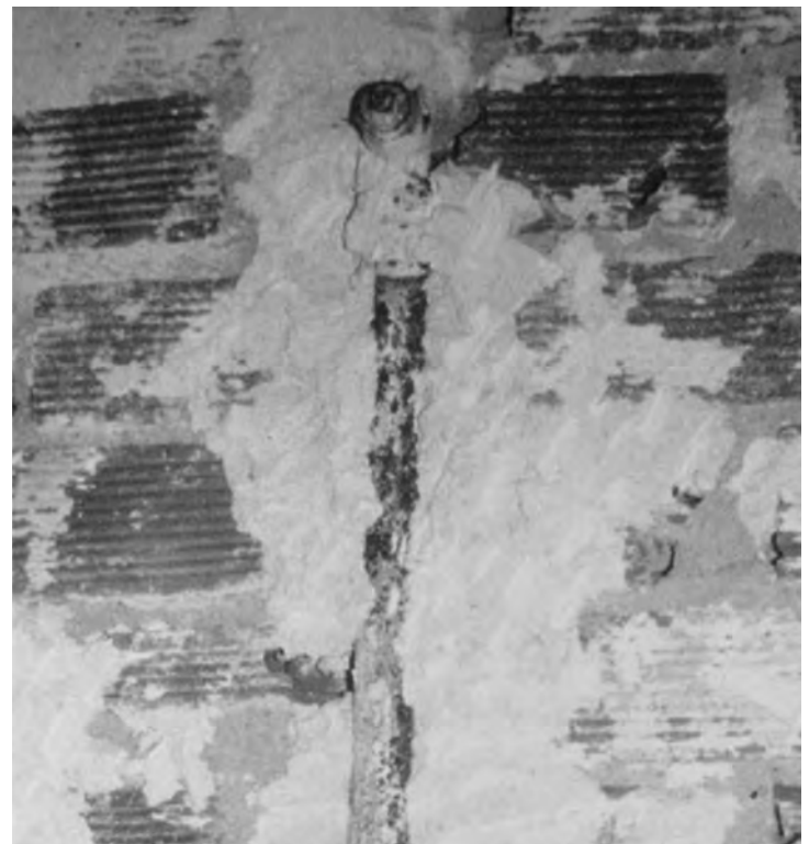
Fig. 7. Desperfectos habituales en fase de ejecución. Yeso recubriendo conducciones de acero galvanizado
